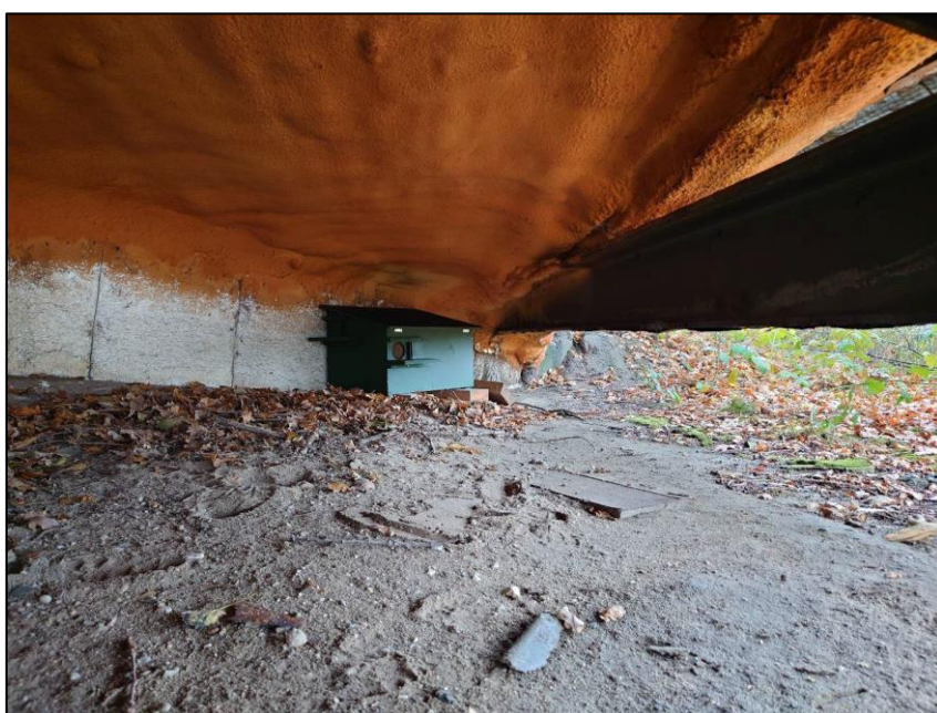
Figuur 4. Geplaatste marterbox onder de overkapping.
